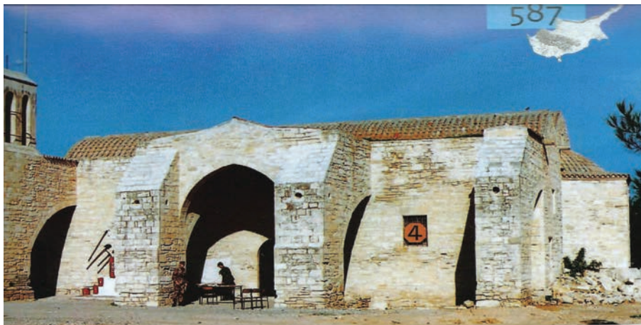
Erdemli (Tremeşe), Tremethousha. St.Spyridon manastır kilisesinin güney cephesi ve dört adet büyük payanda duvarları.
